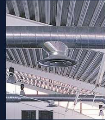
مقاولات تكييف HVAC CONTRACTING
